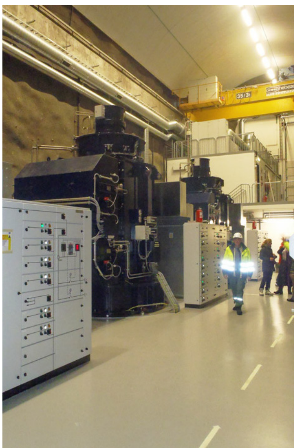
Vandkraftværk ved Paakitsoq der forsyner Ilulissat. Generatorsal. To turbinegeneratorer (de sorte maskiner) sammen med deres styresystemer. (Foto: Mads Fage)
